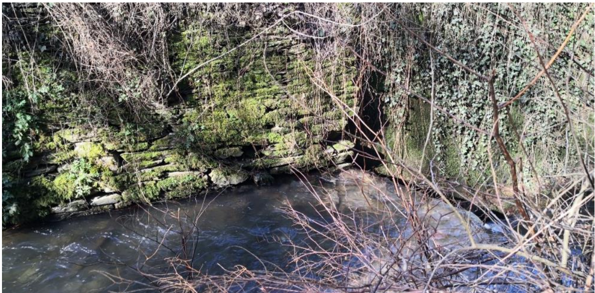
Abb. 4-96: Beispiel einer schon unterspülten Steinstützmauer am Verlauf des Niederbaches
