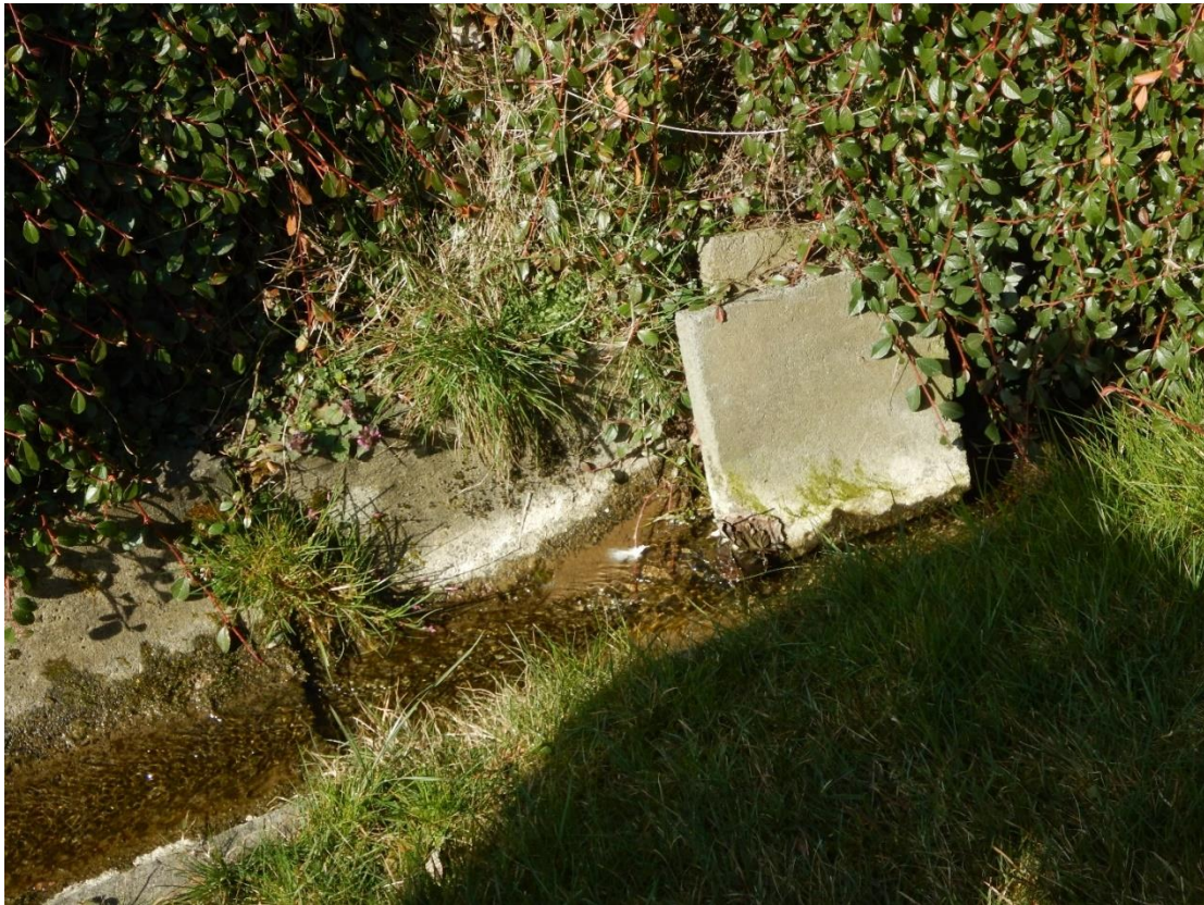
Abb. 4-34: Private Steinplatten, die im Starkregenfall den Durchlass verlegen (H01)
