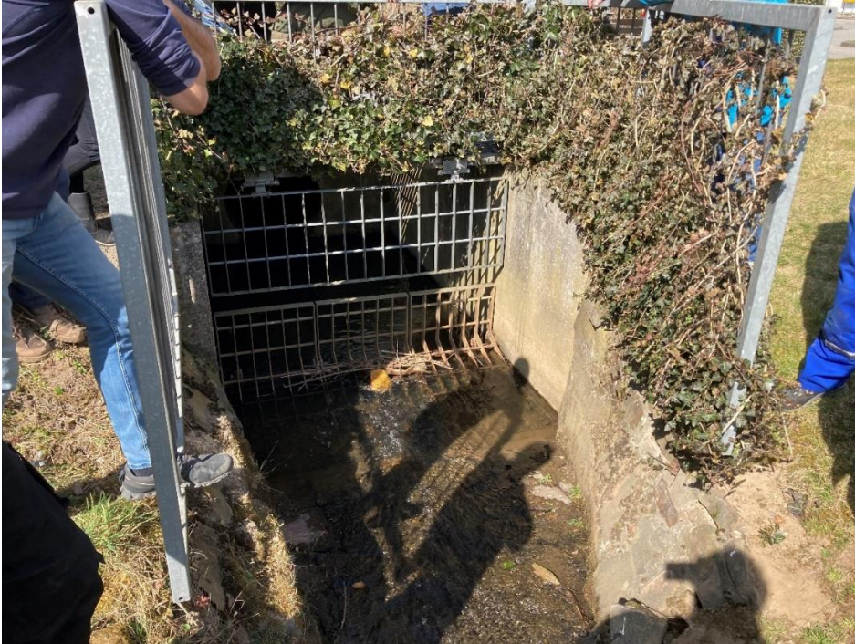
Abb. 4-28: Einlaufbauwerk des Lingerhahner Bachs, das Gitter ist zu klein (H09)
