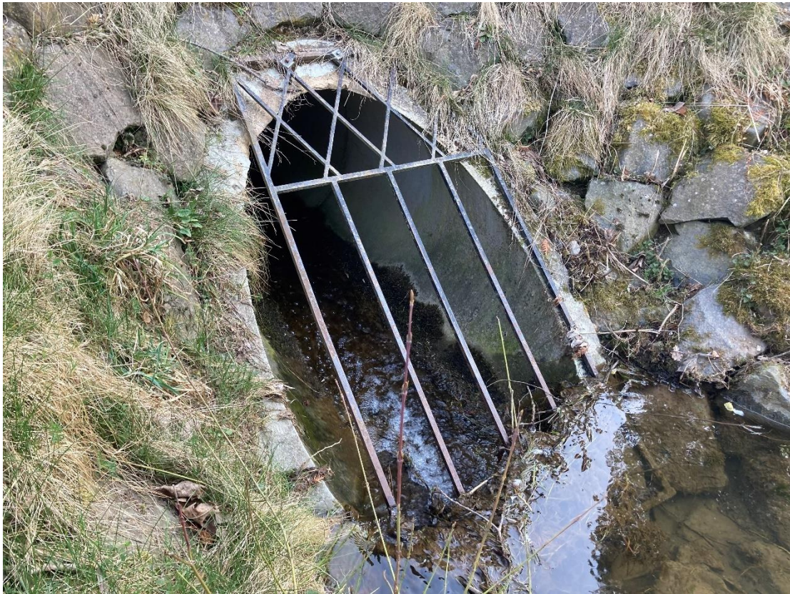
Abb. 4-39: Mit einem Raumrechen zu ersetzenden Rechen vor Verrohrung des Baybaches
