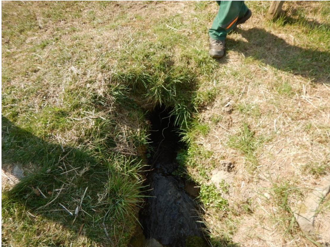
Abb. 4-22: Verrohrung des Johannseifen (Langwiesbach)
