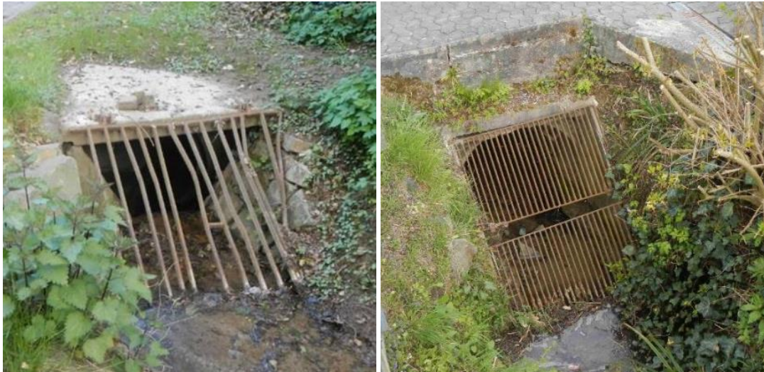
Abb. 4-2: Ungünstiger Einlauf einer Verrohrung
