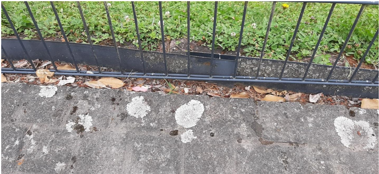
Abb. 4-19: Hochwasserschutz Grundstück mit der Folge der Entwässerung in den Ort
