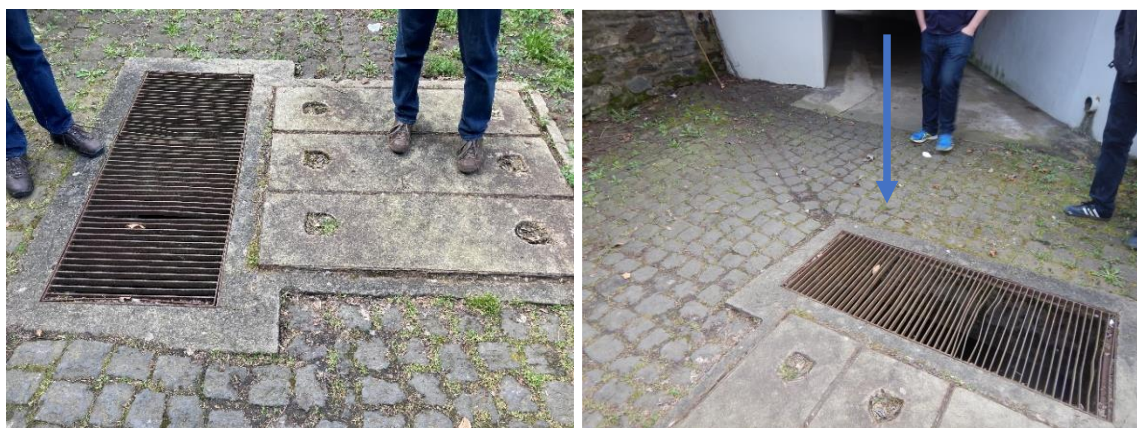
Abb. 4-69: Verschlossener Schacht (links); Fließweg unterhalb der Bahntrasse (rechts)
