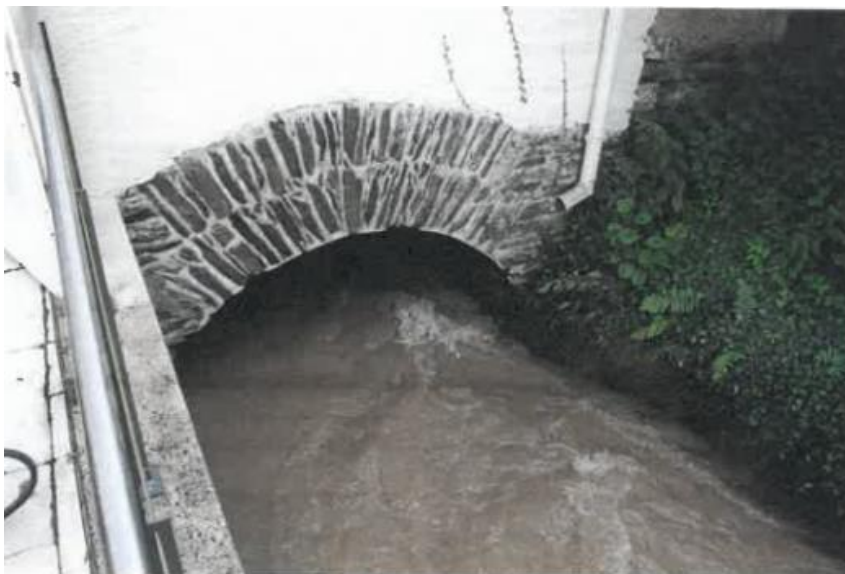
Abb. 4-57: Gewölbe über Gründelbach – Vergleich Normalzustand – Hochwasser (2016)
