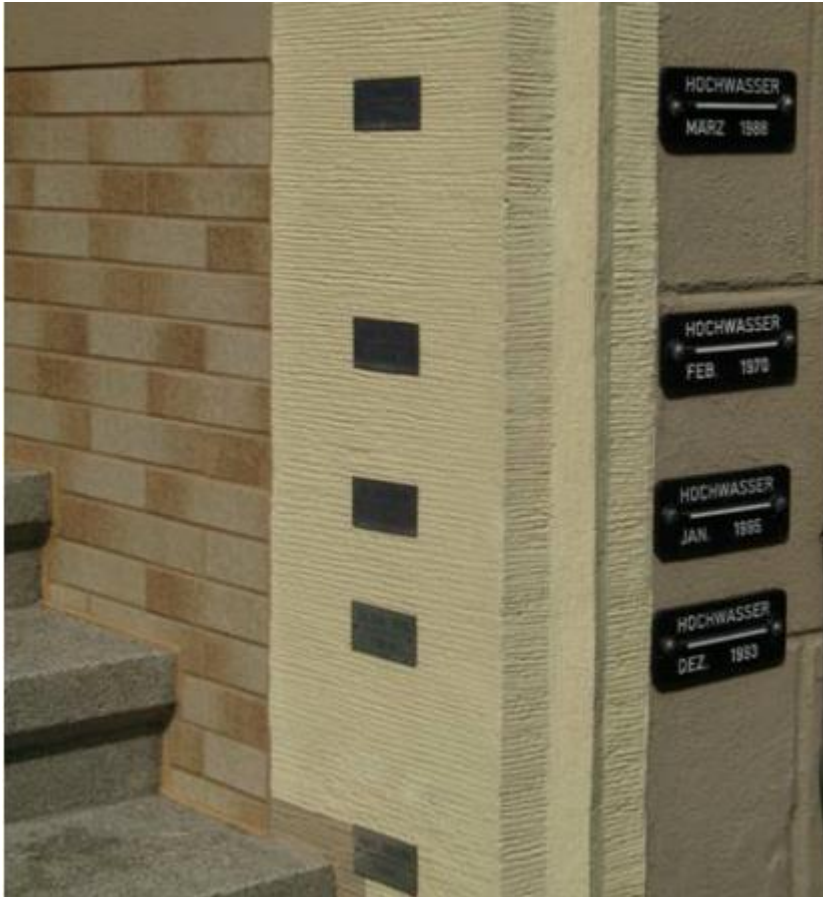
Abb. 4-104: Hochwassermarken Rheinstraße, Oberwesel
